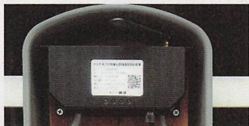
現在設置中の自動検針端末装置
